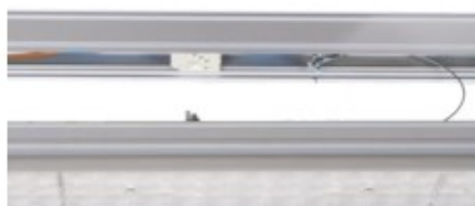
Connecteur rail et luminaire
